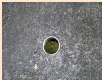
水抜き穴の詰まり
