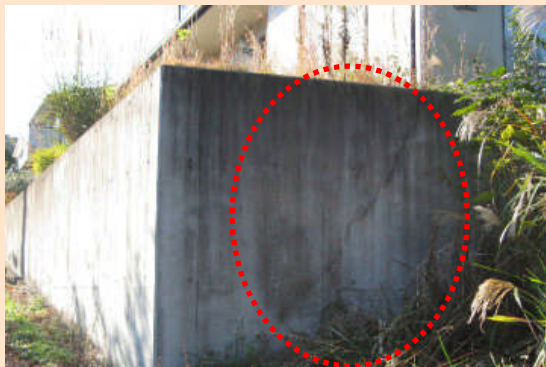
コーナー部でのひび割れ
