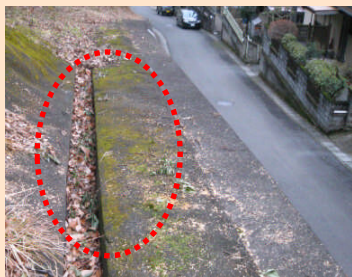
擁壁の上にある排水溝の詰まり
