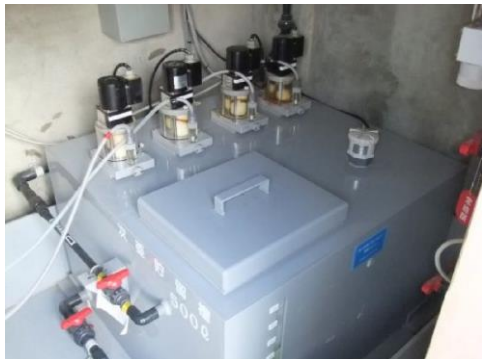
【塩素注入設備】
