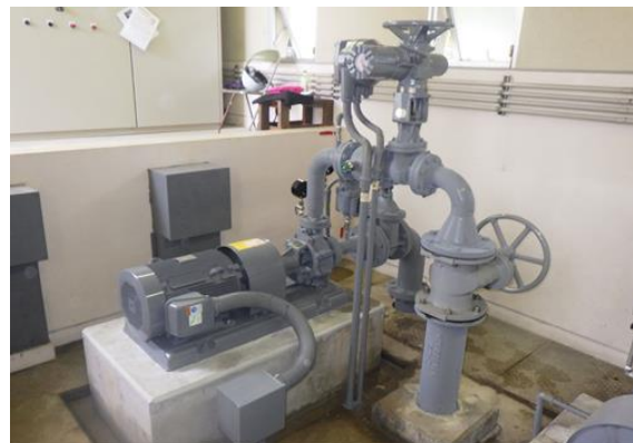
【高効率ポンプへの更新】
