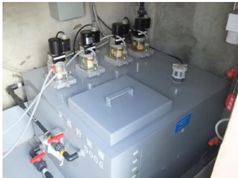
【塩素注入設備】
