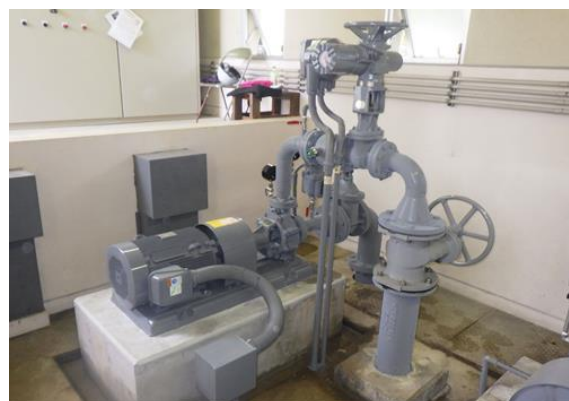
【高効率ポンプへの更新】
