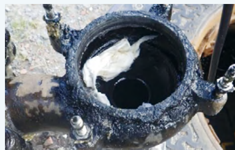
中継ポンプ施設のポンプに詰まった異物
