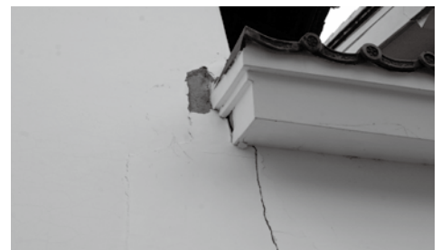
▲(仮称)山田家資料館：壁剥離
