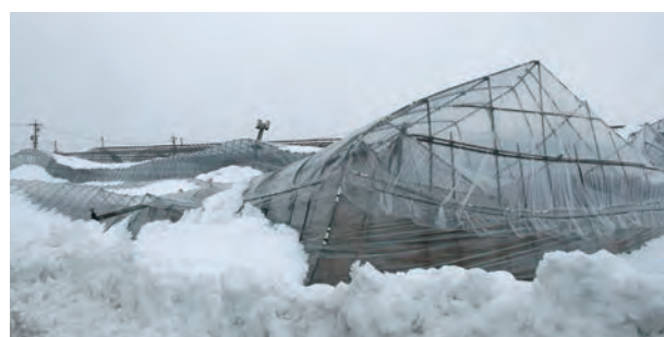
▲雪により倒壊した農業用ビニールハウス
