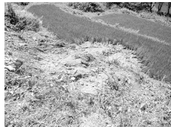
▲法面が崩落し、農地に土砂が流入(永田)
