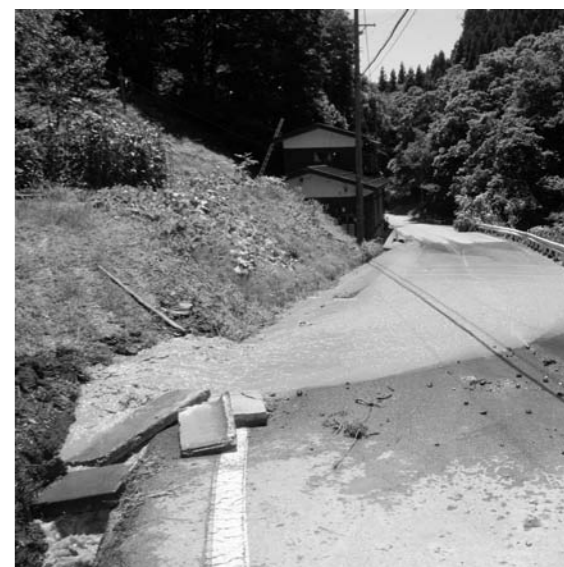
▲増水した川が道路の側溝を破壊(永田)
