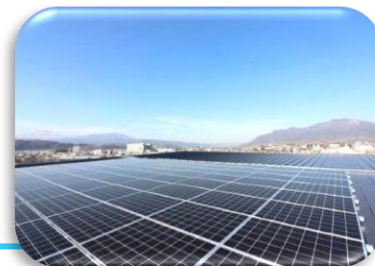
市役所本庁舎の太陽光発電設備
