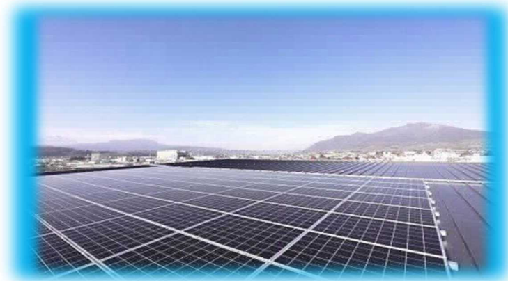
市役所本庁舎の太陽光発電設備
