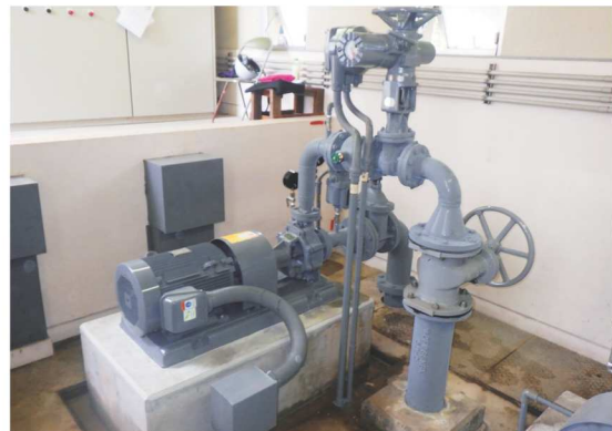
【高効率ポンプへの更新】
