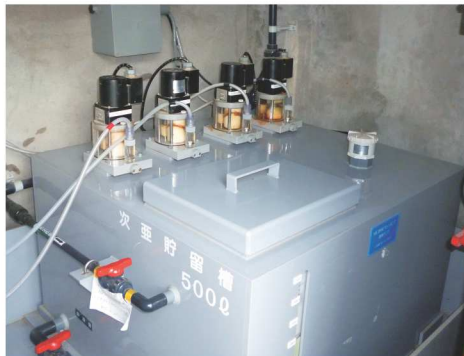
【塩素注入設備】
