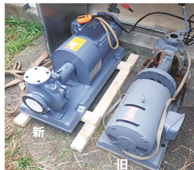
【高効率ポンプへの更新】
