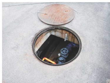
田麦第2水源（深層地下水取水）
