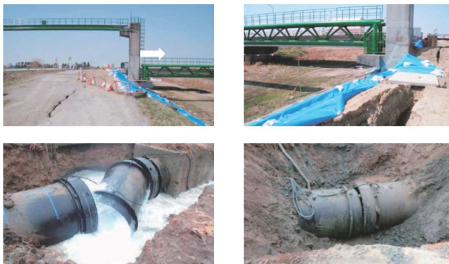
【東日本大震災で被災した水管橋等】 ※厚生労働省報告書より
