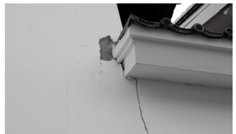
▲(仮称)山田家資料館：壁剥離
