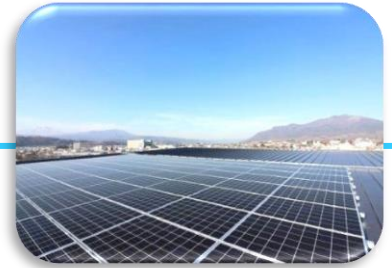
市役所本庁舎の太陽光発電設備
